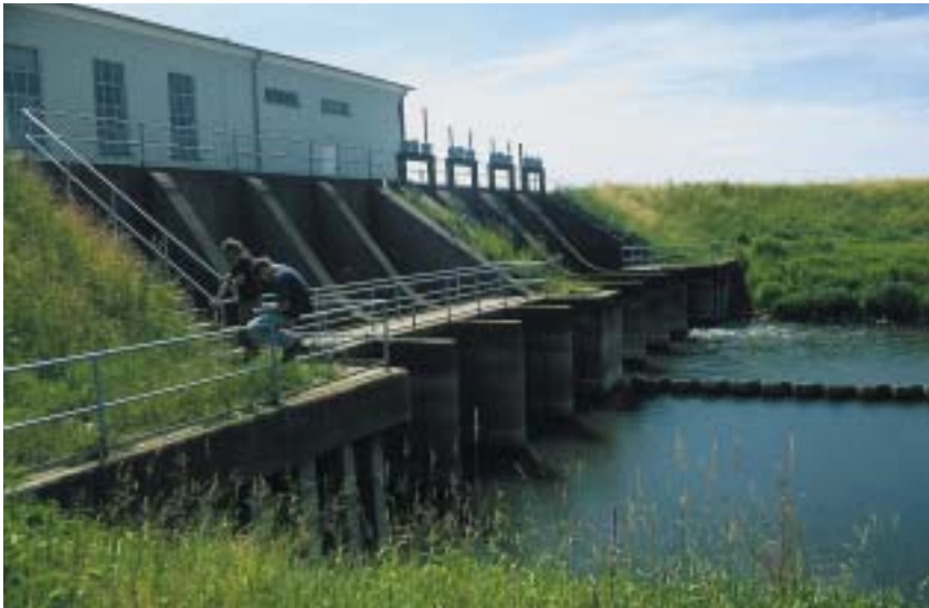
Abb. 10: Schöpfwerk an der Sudemündung in die Elbe. Das Bauwerk behindert den Fische Austausch, unterbindet ihn jedoch nicht gänzlich.
